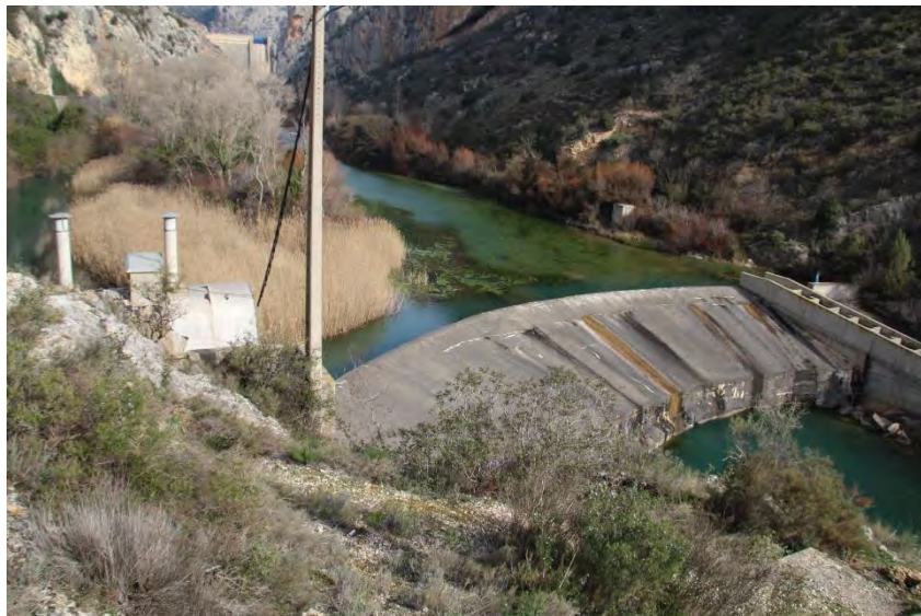
Figura 38. Azud del Canal de Piñana, al fondo escala de peces y toma de la acequia de Ivars de Noguera.
