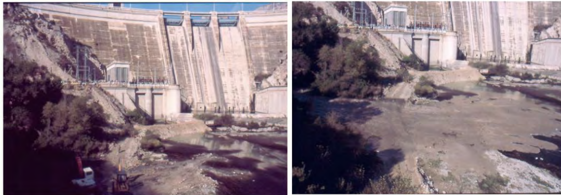
FIGURA 27. Izquierda: Condicionamiento del lecho del río en el pie de presa para el vaciado del embalse de Santa Ana. Derecha: Apertura de las compuertas de fondo del embalse de Santa Ana (octubre de 1988) para su limpieza y reparación. Autor: Carles Balasch.
