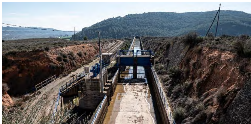
Figura 36. Compuerta y derivación agua de boca del Canal de Enlace.
