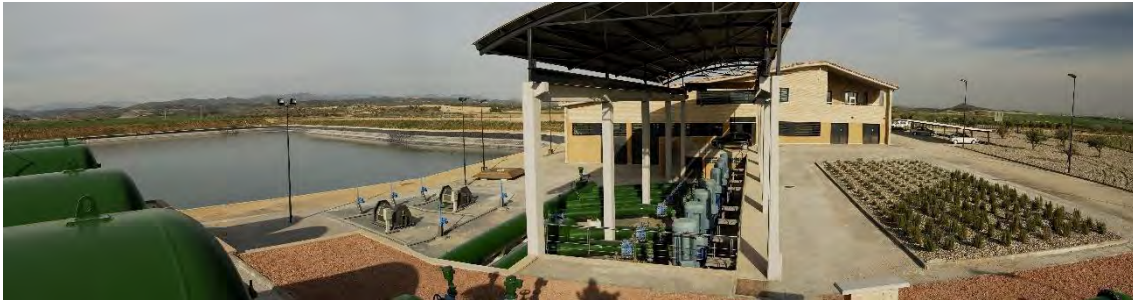
Figura 44. Estación de bombeo del Canal de Algerri Balaguer.
