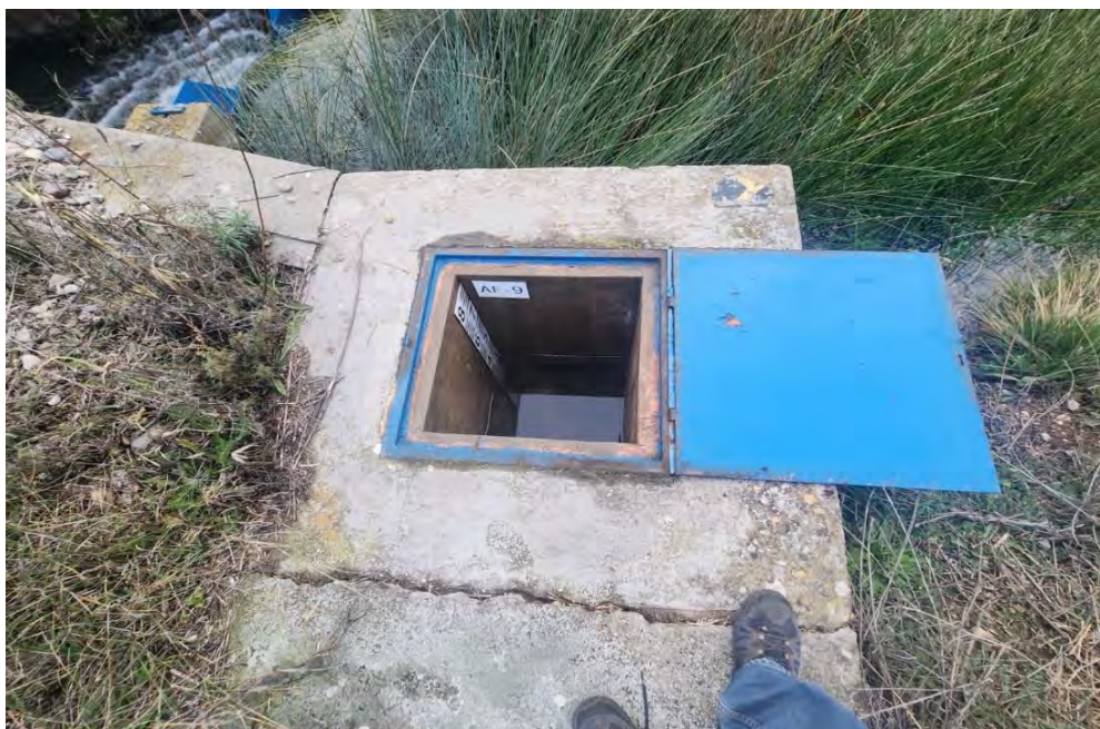
FIGURA 18. Pozo de medida del nivel de la lámina de agua circulante mediante una escala limnimétrica.
