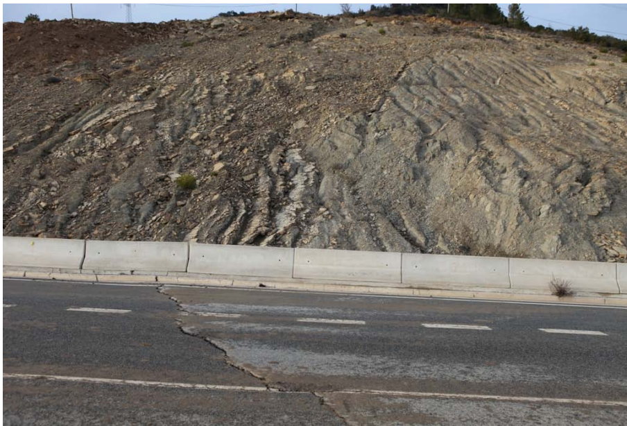
Figura 2. Grieta con movimiento sinistro afectando a la carretera ZN-240 en el límite este del deslizamiento de 2012-13. En este sector, el movimiento afecta a sedimentos eocenos sin evidencias de haber sido afectados por deslizamientos previos. Nótese la continuidad de los estratos de arenisca y margas. El plano de rotura parece adaptarse al contacto entre el flysch y las margas infrayacentes. Imagen tomada el 8 de marzo de 2013. Punto 25 del mapa.
