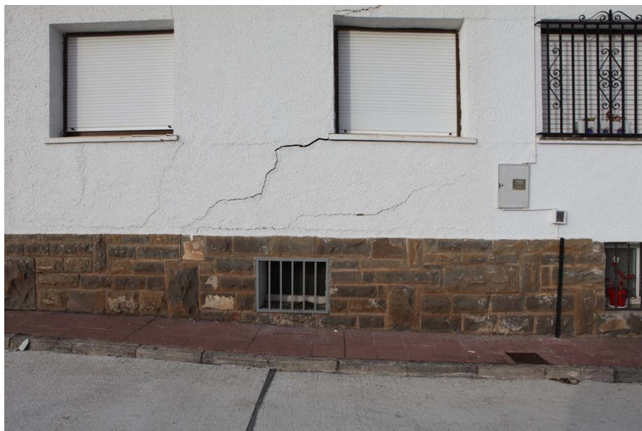
Figura 3. Grietas en el límite oeste del deslizamiento activo afectando a una vivienda en la urbanización Lasaitasuna. Imagen tomada el 8 de marzo de 2013. Punto 29 del mapa.
