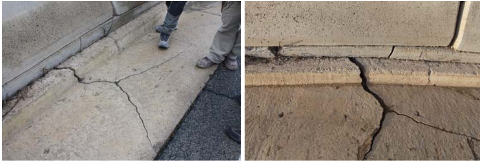
Figura 20. Fotografías tomadas el 13 de diciembre de 2012 (izquierda) y el 16 de febrero de 2013 (derecha) mostrando grietas afectando a la carretera ZN-240 en el límite este del deslizamiento activo (punto 25).
