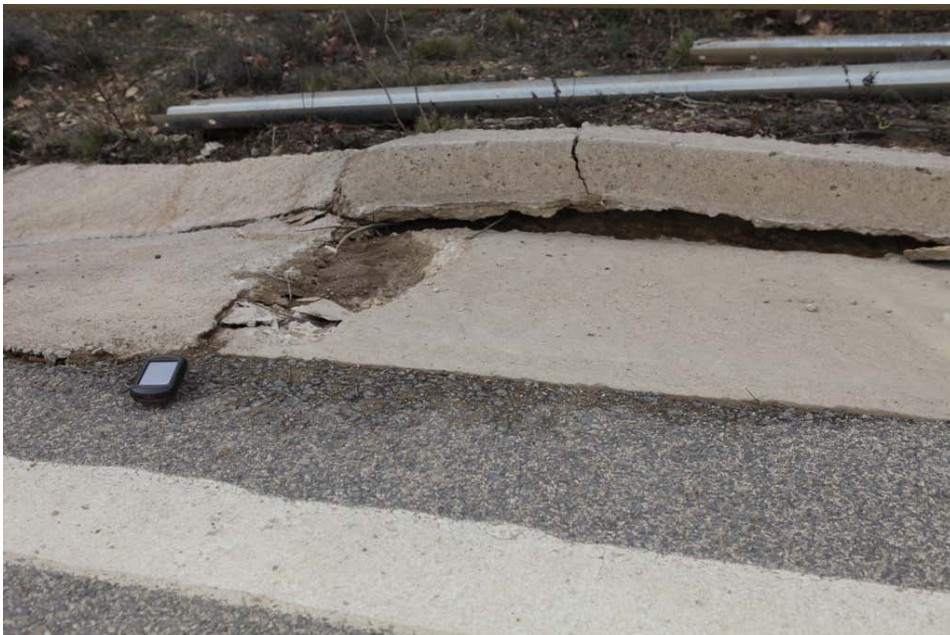
Figura 24. Deformaciones recientes afectando a la cuneta norte de la carretera ZN-240 en el límite oeste del deslizamiento activo (punto 31). Imagen tomada el 16 de febrero de 2013. El 13 de diciembre de 2012 no se detectó esta deformación.
