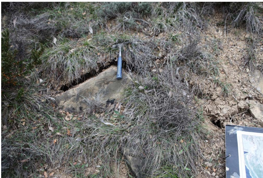
Figura 19. Grieta de tracción situada por encima del deslizamiento antiguo (punto 24) descubierta el 8 de marzo de 2013.
