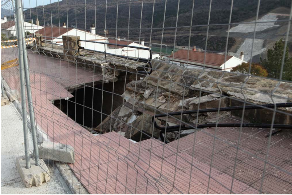
Figura 23. Colapso en la acera de la calle centro-superior de la urbanización Lasaitasuna (punto 29). Imagen tomada el 16 de febrero de 2013.
