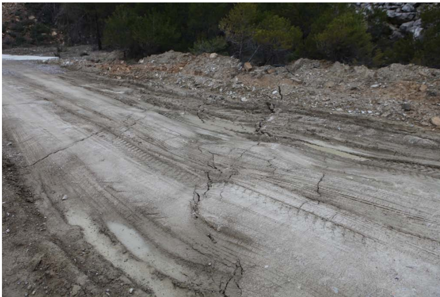
Figura 21. Grietas y escarpes con orientación principal oeste correspondientes al límite este del deslizamiento activo (punto 26). Imagen tomada el 8 de marzo de 2013.
