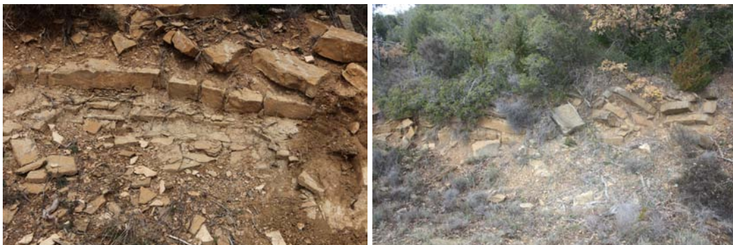
Figura 16. Punto de observación 19, en el que las capas de arenisca, aunque localmente muestran continuidad, se encuentran afectadas por juntas rellenas de material arcilloso, o muy fracturadas.
