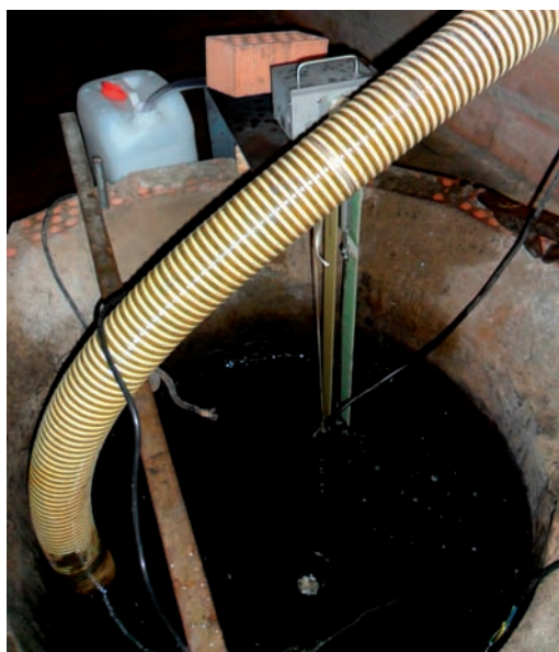
■ FIGURA 5.3.49 POZO DE ACHIQUE 251670122. DETALLE DEL SKIMMER INSTALADO. ZONA 081-01
