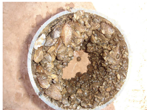
Fotografía 5: tubería colonizada por Dreissena polymorpha
