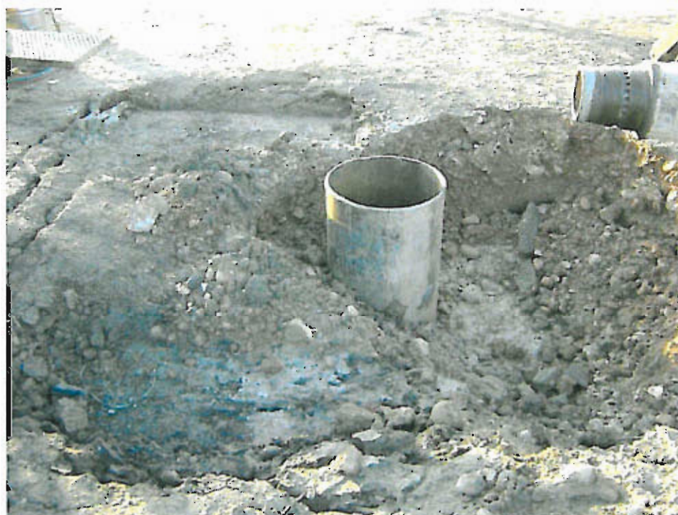
Detalle del colapso
