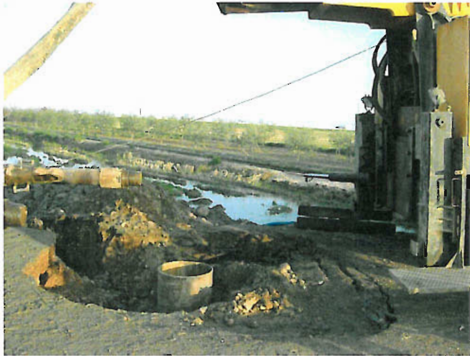
Colapso con la perforación en 9 m
