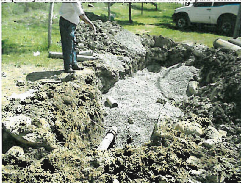
Detalle de la tubería reparada y de la grava vertida a su alrededor.
